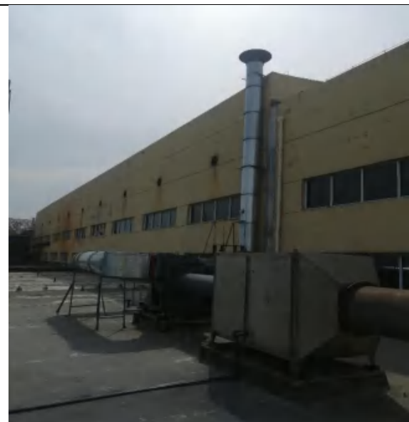
1#危废间排气筒
