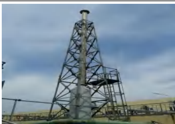
污水处理厂废气排气筒
