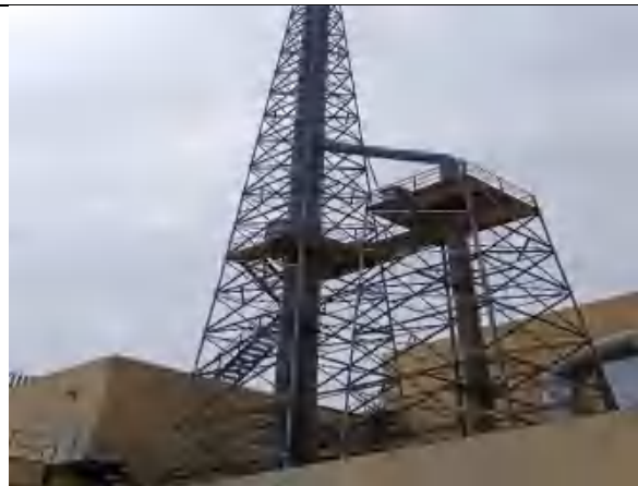
焚烧车间废气排气筒
