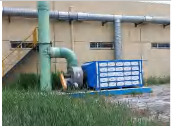
2#危废间排气筒
