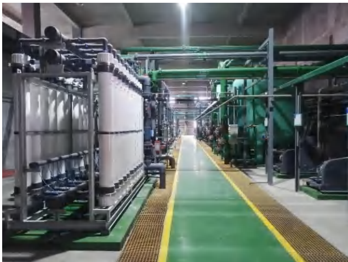
图 5.1-2 高盐废水处理装置
