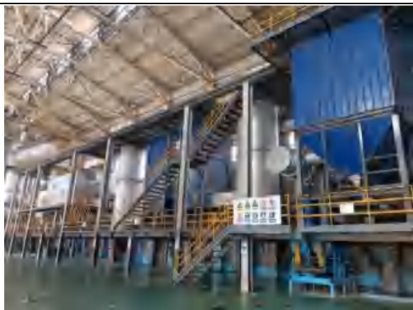
高氮焚烧装置废气治理设施
