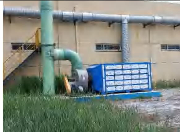
2#危废间排气筒
