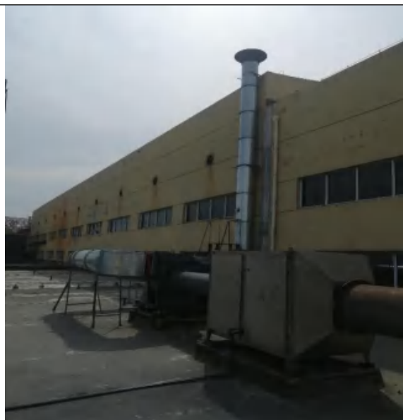
1#危废间排气筒
