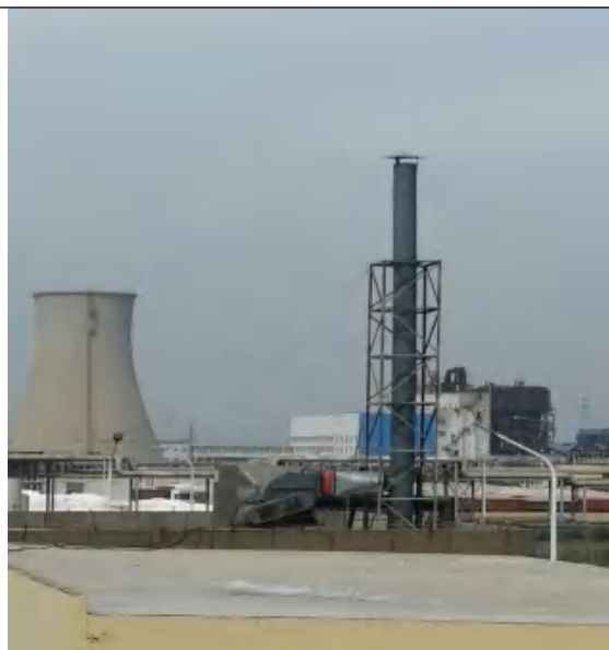
料坑废气排气筒
