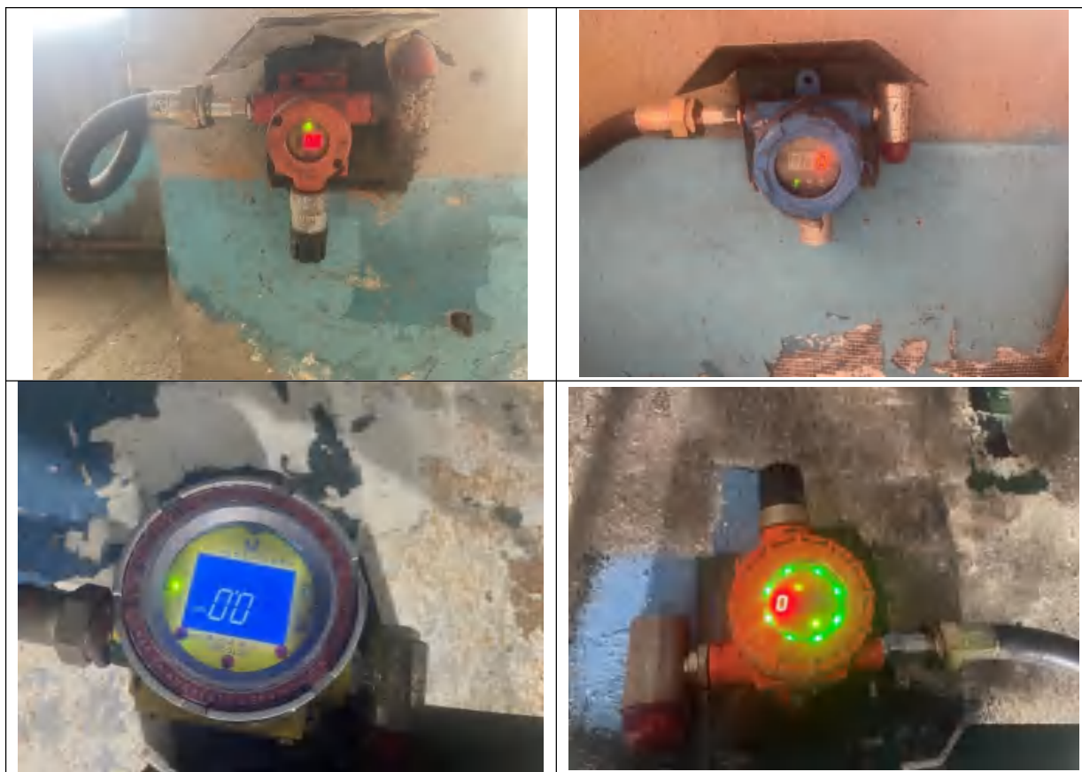
图 5.2-2 可燃气体、有毒气体泄漏检测报警仪
