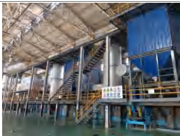
高氮焚烧装置废气治理设施
