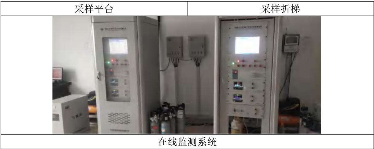
图 5.2-3 废气排放口及在线监测
