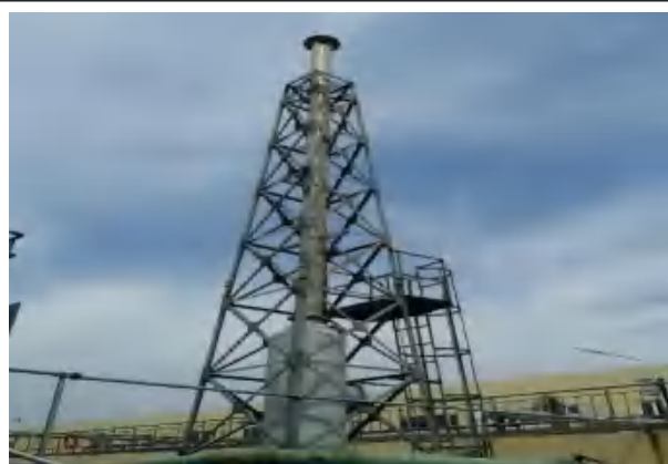
污水处理厂废气排气筒
