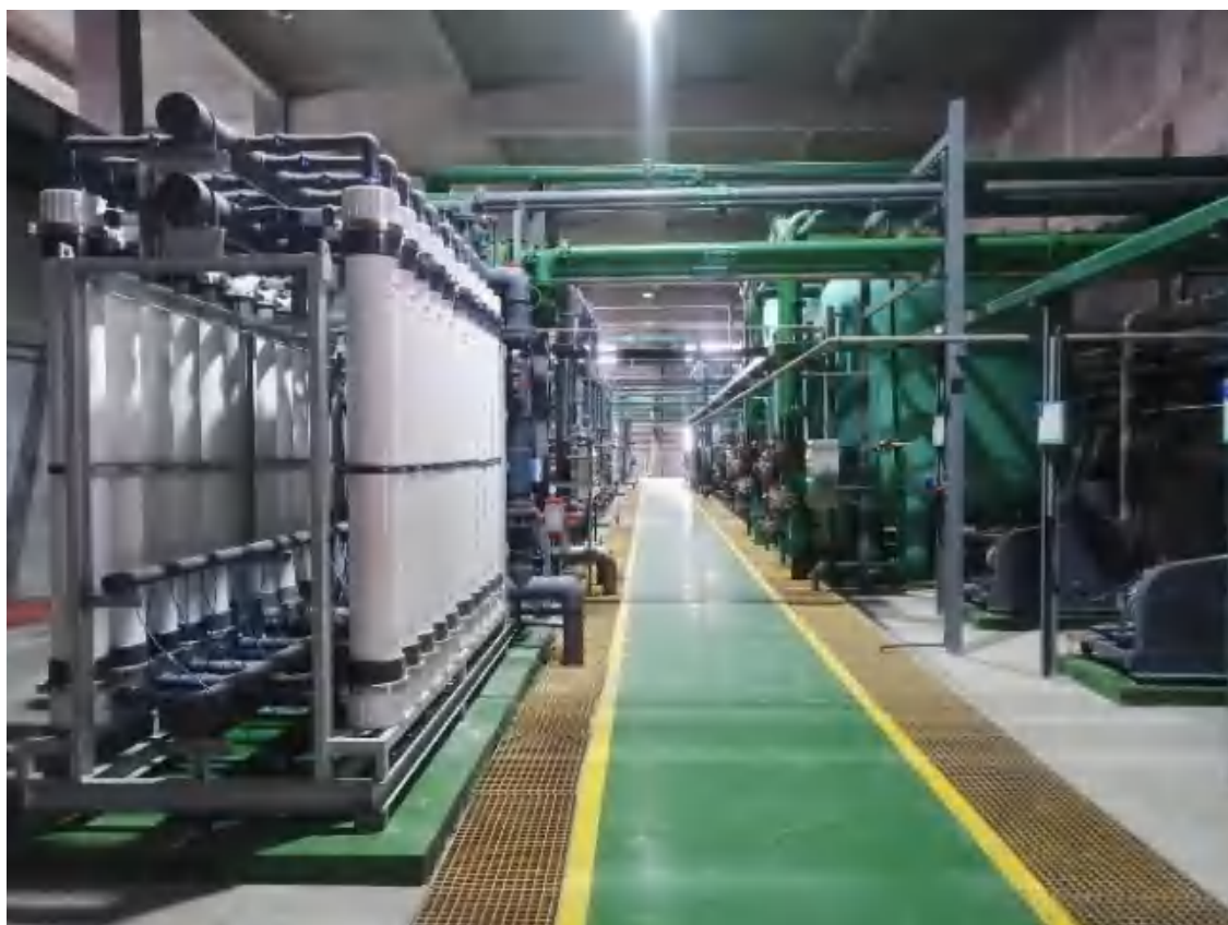
图 5.1-2 高盐废水处理装置
