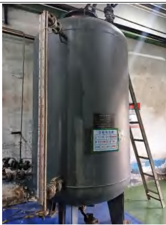
重组分废液罐
